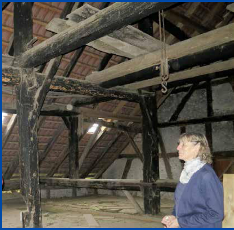
Die Mehrreihen-Ständerbaukonstruktion ist nur noch selten anzutreffen. Sie wurde bei besonders grossen Häusern angewandt.
