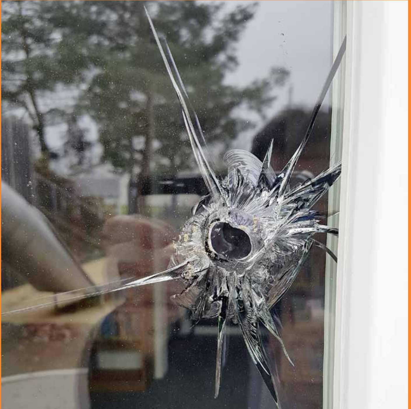
Demoliertes Fenster bei der Primarschulturnhalle
