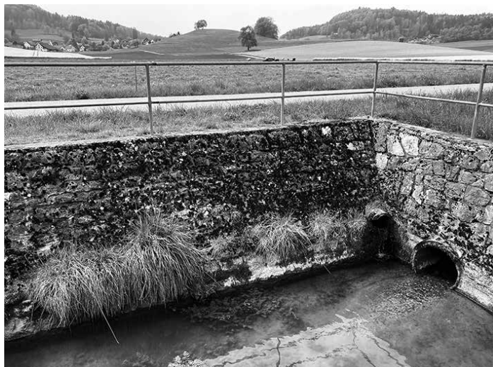
Sandfang im Schleumet, Mai 2022
